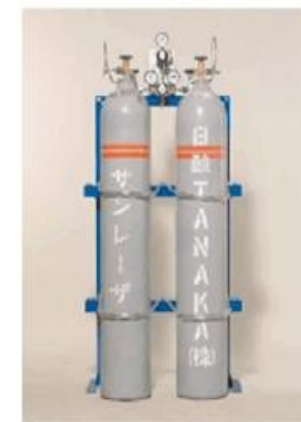
CO 2 レーザー切断機向け レーザーガス供給設備
